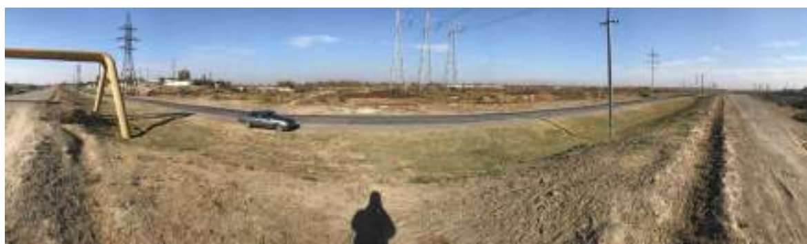
Иллюстрация 2-25 #10 – Газопровод через Основной канал
