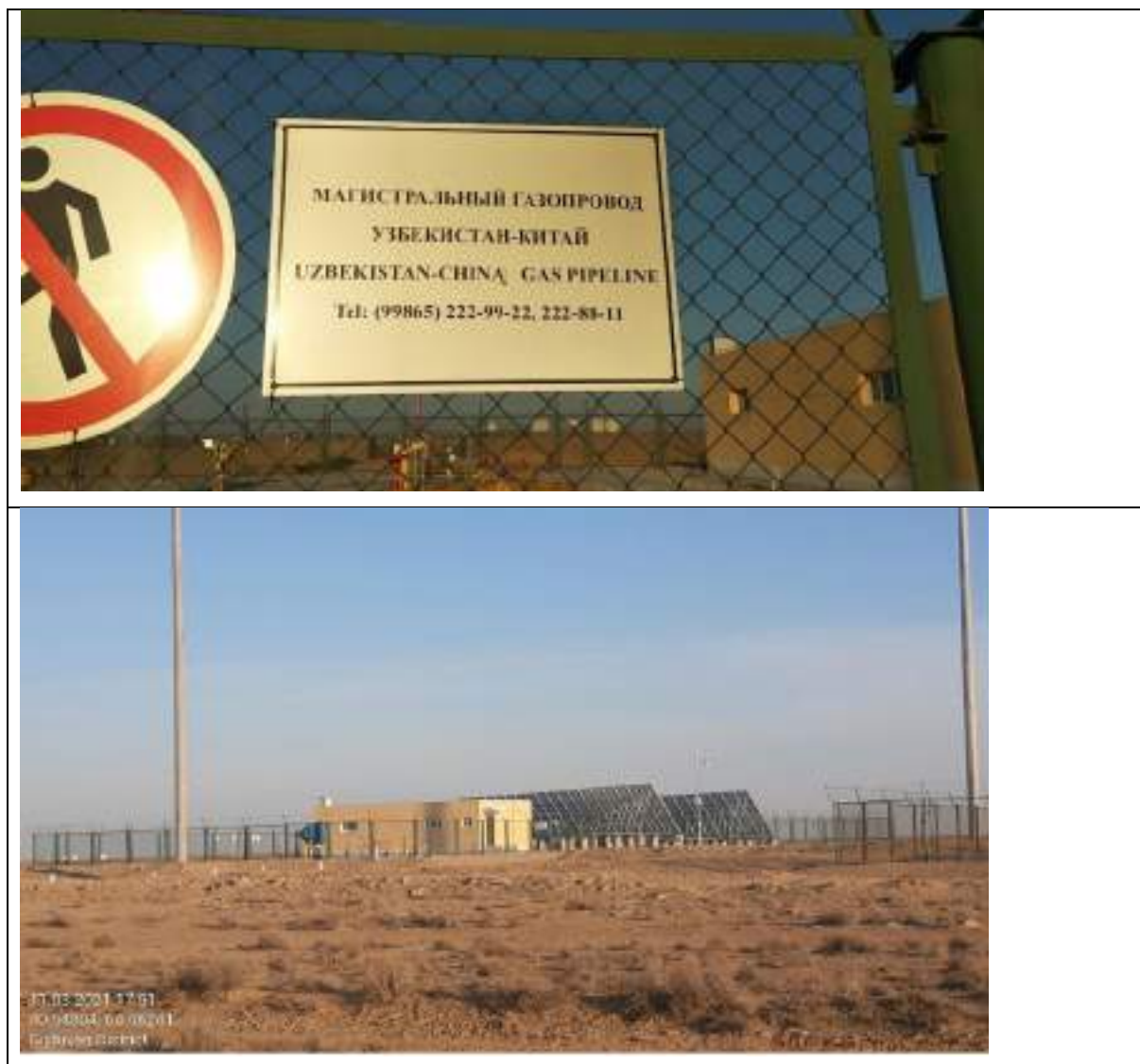
Фото 12-1. Газовые объекты на территории проекта
