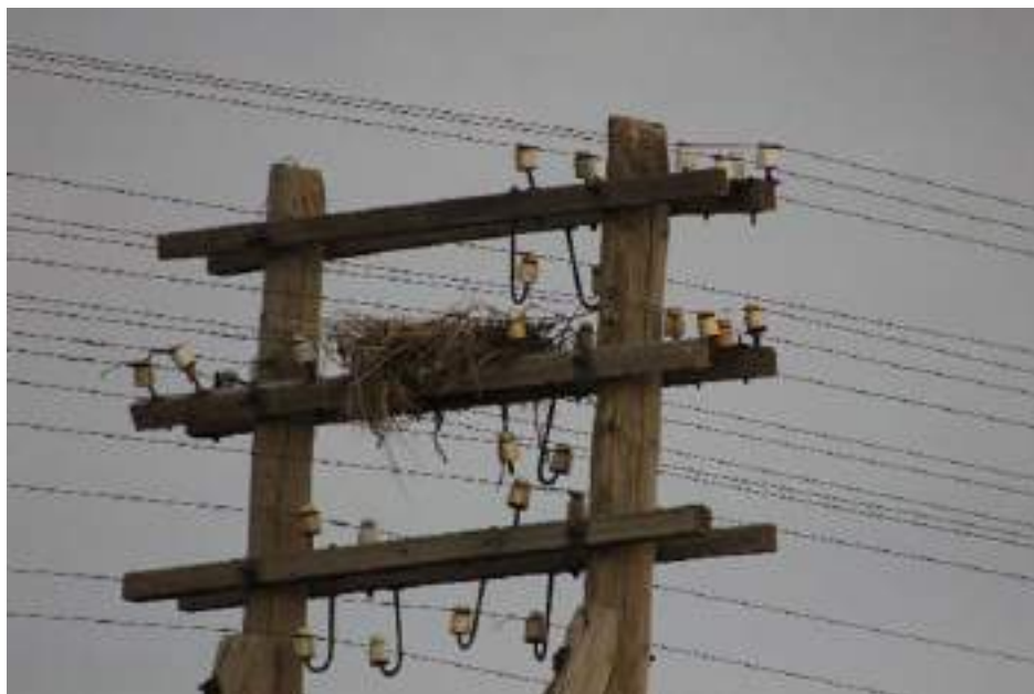
Фото 17-3 Гнездо обыкновенного канюка зафиксировано на действующем столбе линии электропередач
