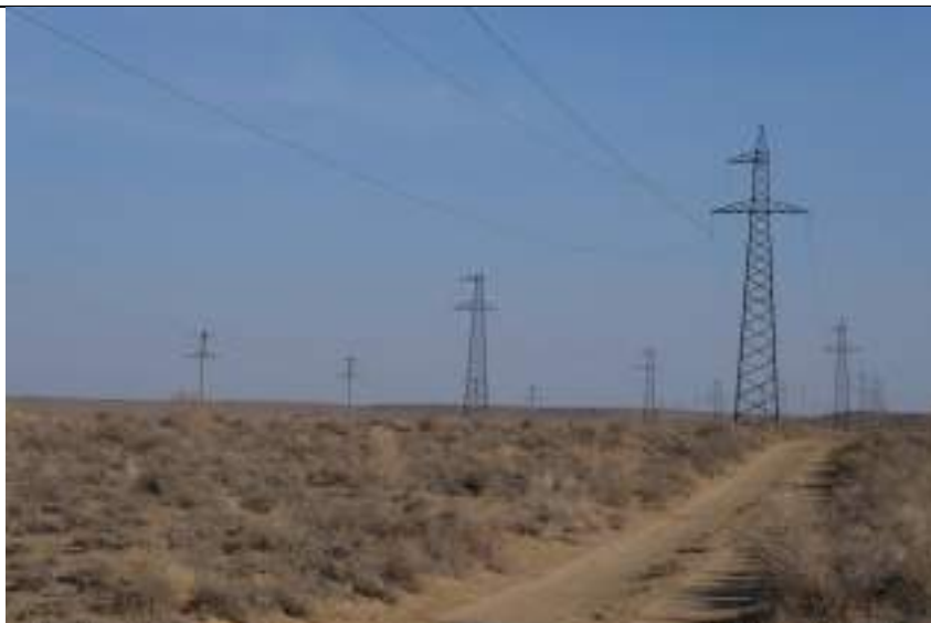
Фото 12-3. ВЛЭП на площадке Проекта
