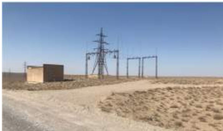
#R31– Вид на ВЛЭП и строение, принадлежащее сетевой компании
